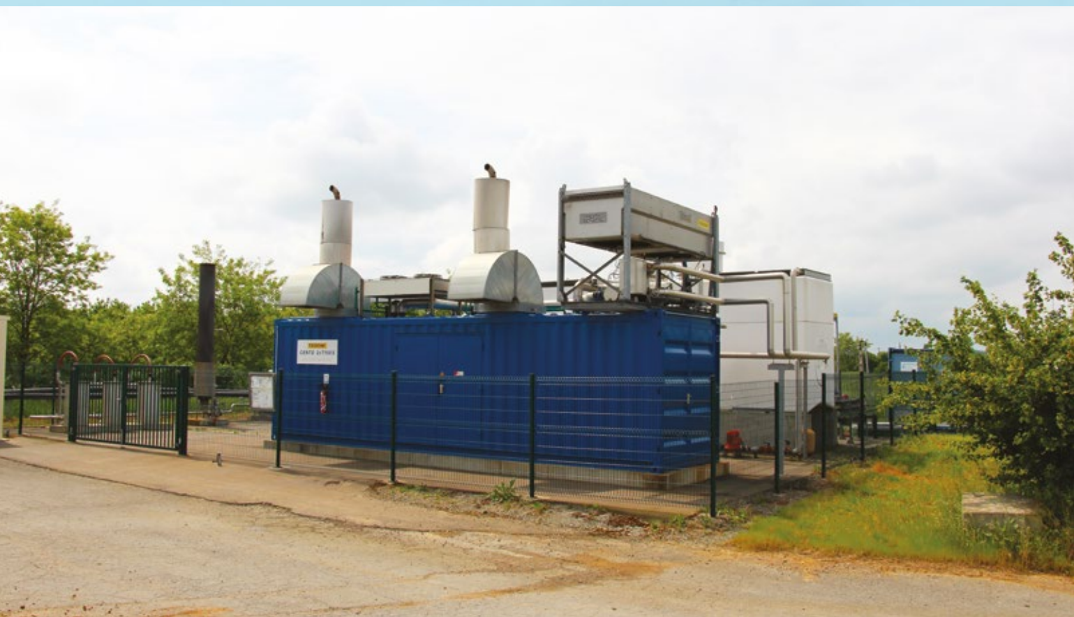
L'unité de valorisation de La Loge : un partenariat durable entre 3D ENERGIES et le SMITED.
